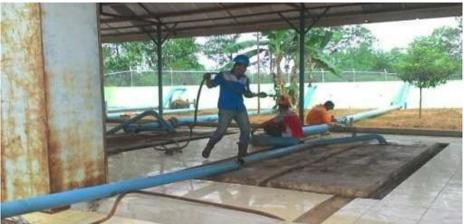
Gambar 2 Pekerja yang Tidak Menggunakan APD Lengkap Saat Bekerja
